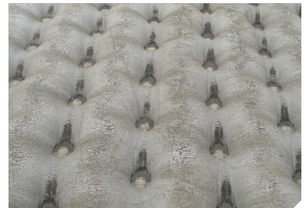
Un bloque de Punto de Filtro Instalado mostrando los puntos de filtración.
