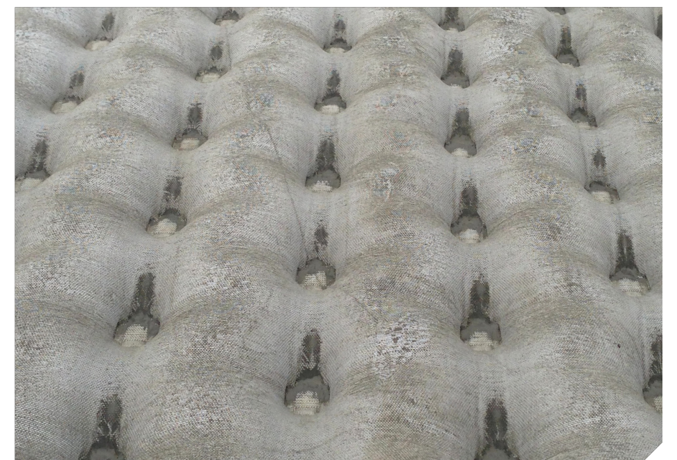
Un bloque de Punto de Filtro Instalado mostrando los puntos de filtración.
